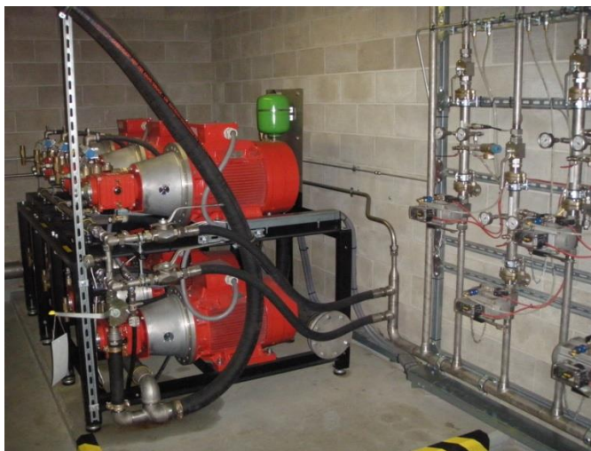
Obr.6 Požární čerpadla v NTK. Zdroj: vlastní
